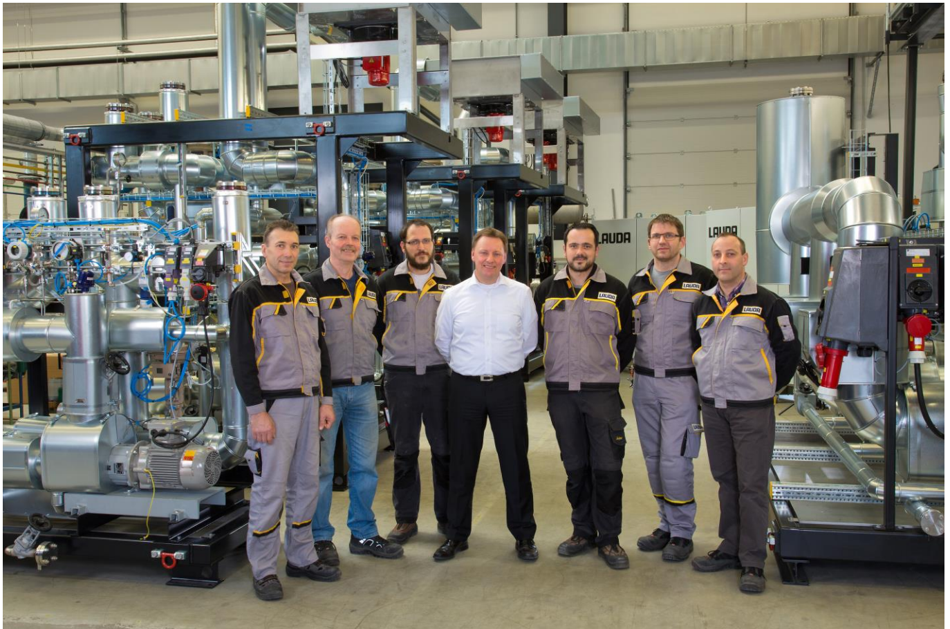
Bild: Perfekte Teamarbeit: Für einen Chemiekonzern aus der Schweiz entwickelte und lieferte der Temperierspezialist LAUDA ein Gesamtkonzept zur Temperierung von Reaktoren und Katalysatoren im Temperaturbereich von 50 bis 360 °C.
